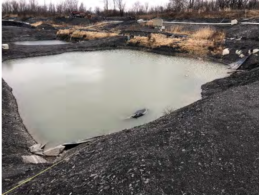
Photographie no. 7: Bassin de décantation
