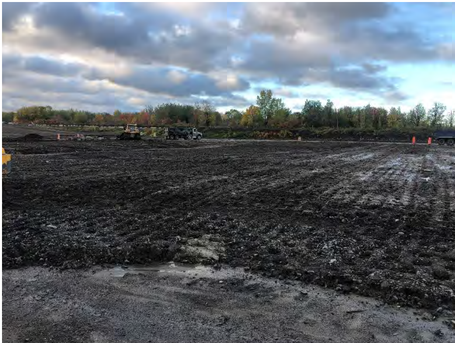
Photographie no. 7: État des sols compactés
