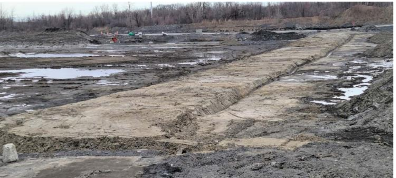
PHOTO 6 : Vue en direction nord des travaux d'aménagement aux abords du futur bassin d'eau (versant est) (Avril 2023)
