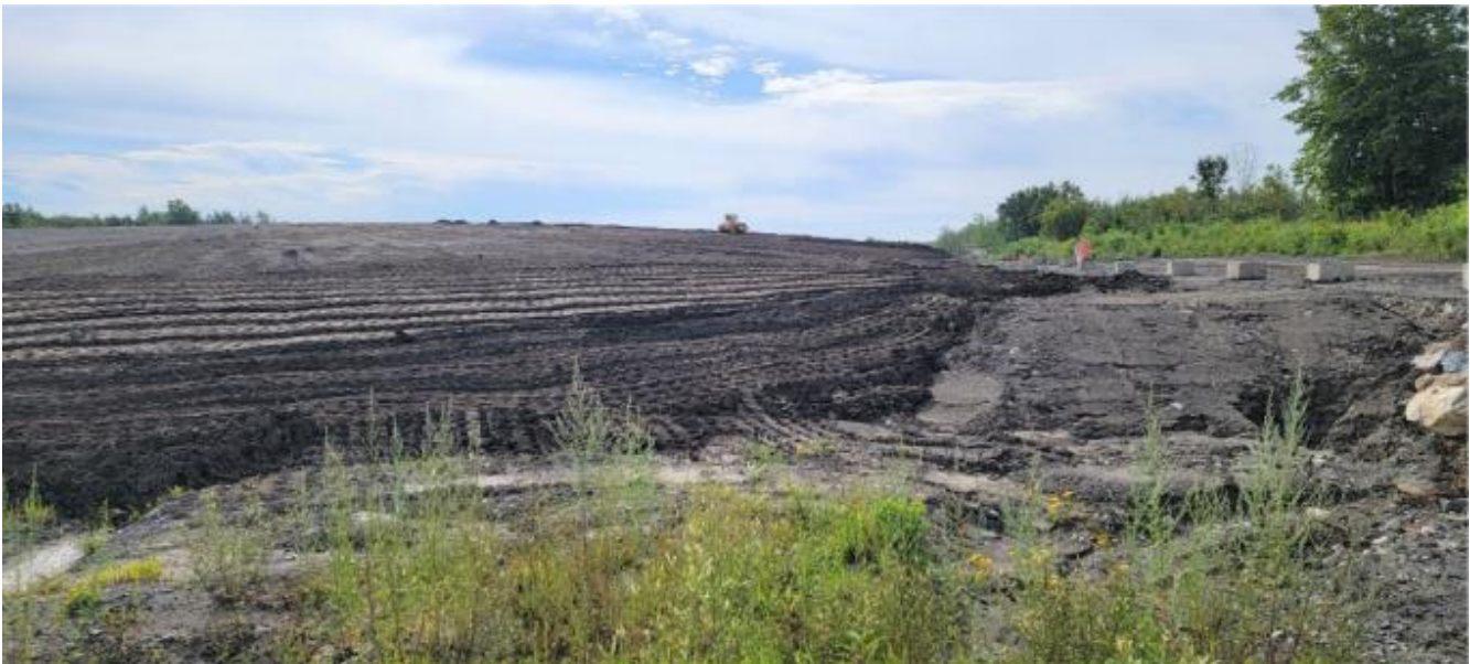
PHOTO 14 : Aire de disposition des sols importés et compactés, localisée au pied du talus ouest (flanc sud-ouest) (Août 2023)
