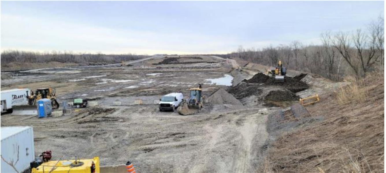
PHOTO 5 : Vue en direction est des travaux d'aménagement aux abords du futur bassin d'eau (versant sud) (Avril 2023)
